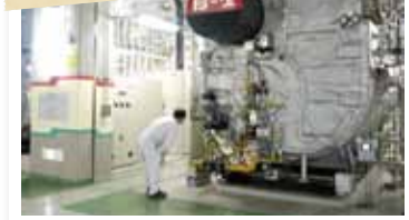
1台でファンヒーター1700台分に相当するパワーをもつ蒸気ボイラー
