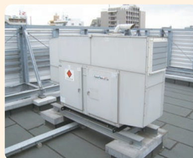
非常用発電装置(蘇我支店)
